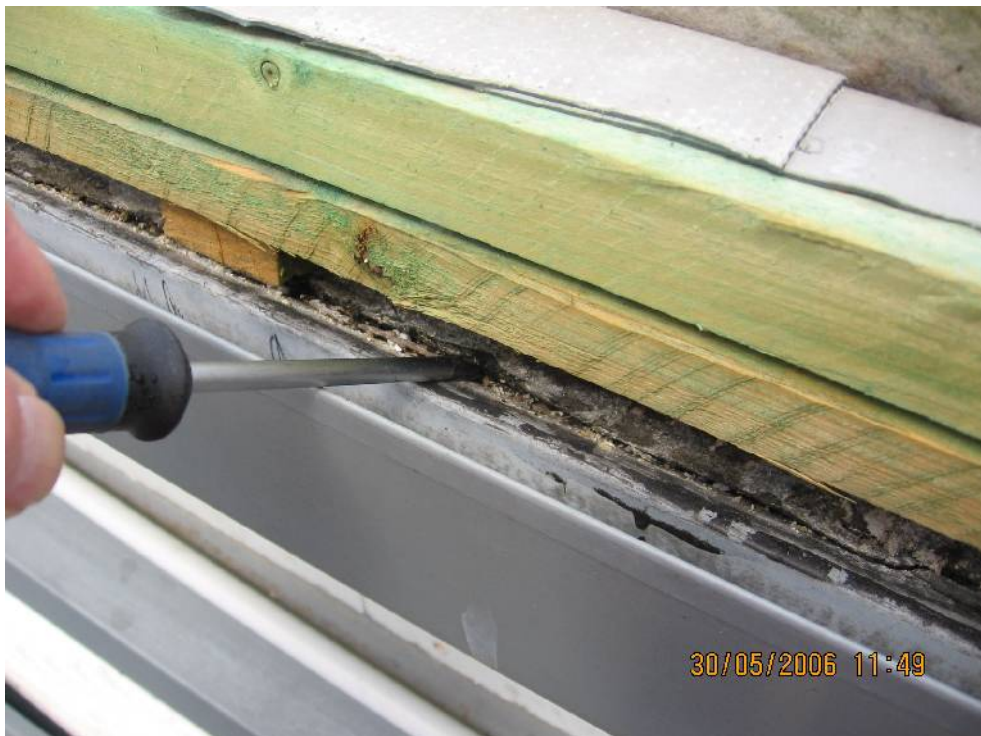
Abbildung 25: Hier dringt Wasser unter der Abdichtung ein
