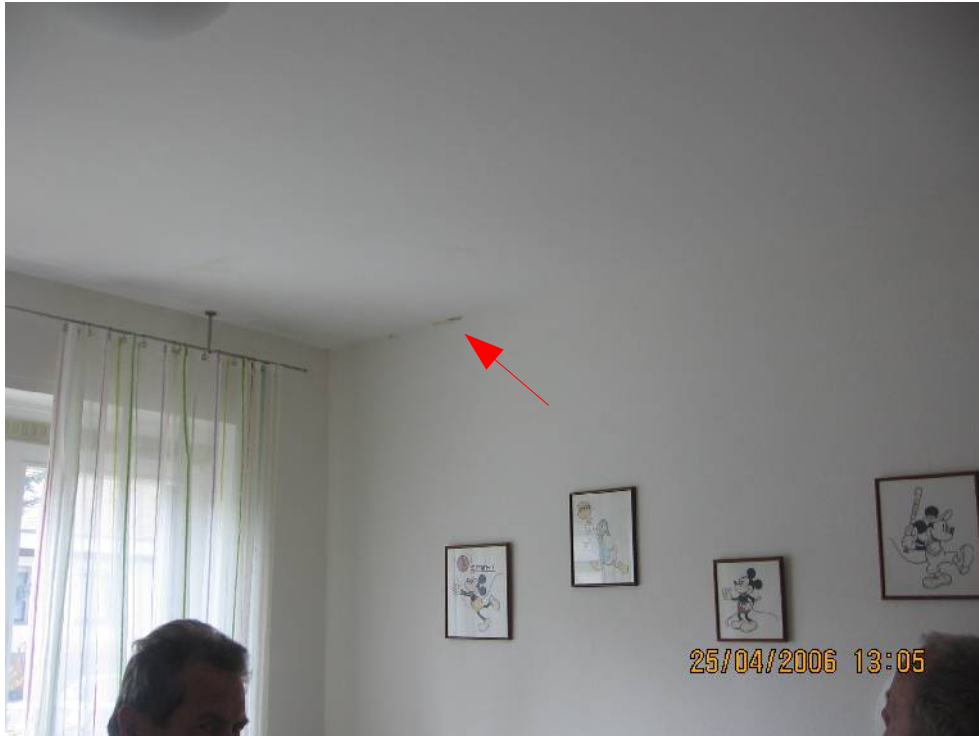
Abbildung 1: Feuchtespuren im Kinderzimmer
