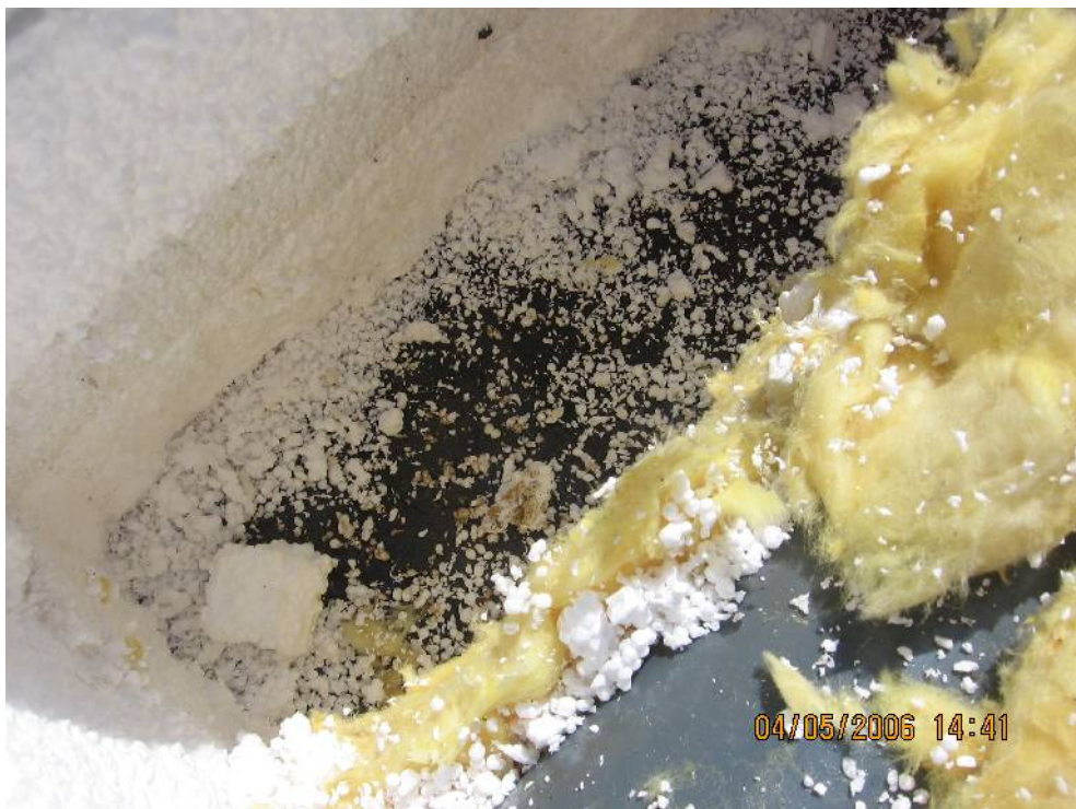
Abbildung 17: Kein Wasser, Mineralwolle feucht
