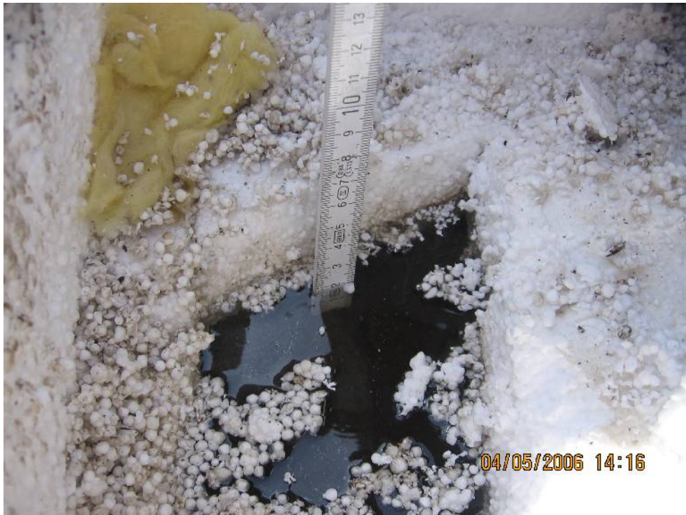
Abbildung 14: Auf der Dampfsperre stehendes Wasser (Ablauf 1)
