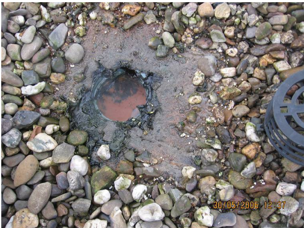
Abbildung 29: Rauch aus Entwässerungsrohr
