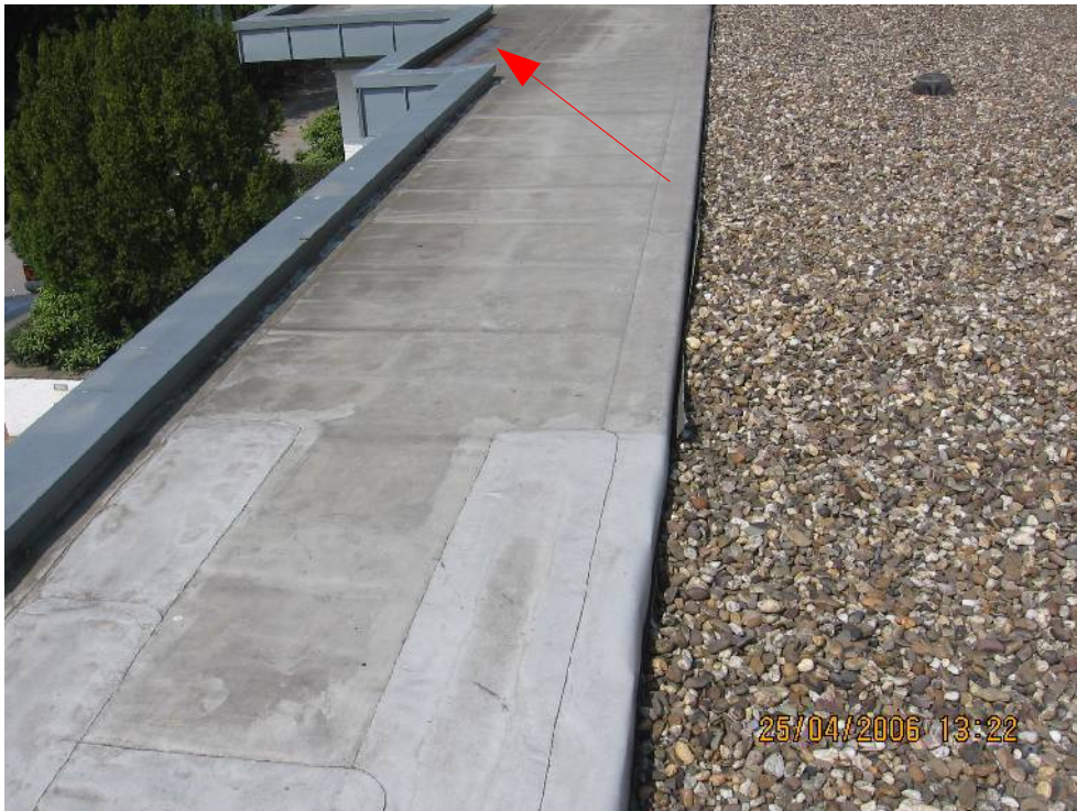
Abbildung 2: Erhöhter Dachrand, Pfützenbildung
