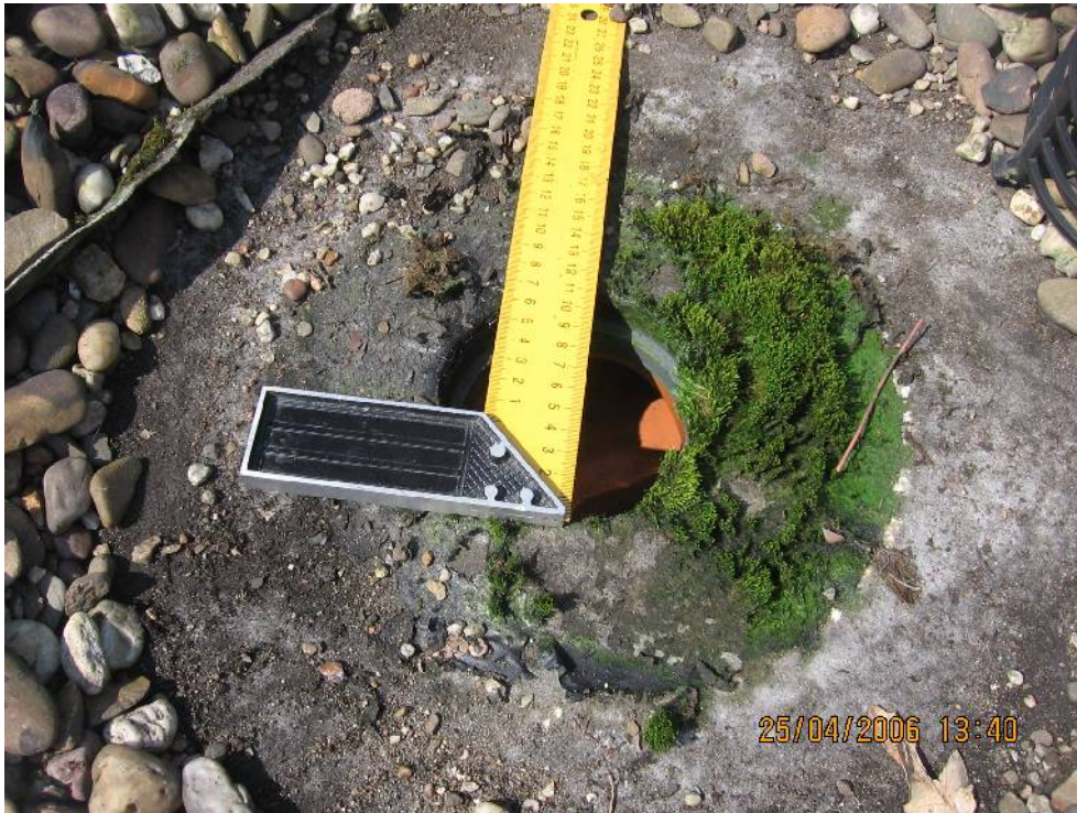
Abbildung 3: Zu hoch eingebauter Dachablauf
