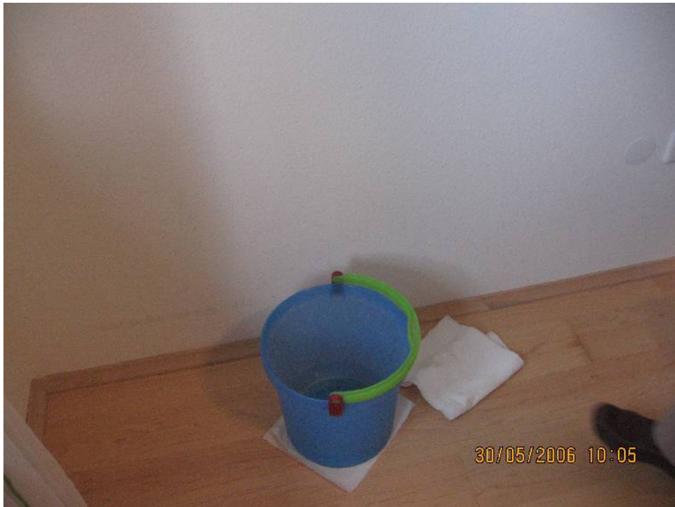
Abbildung 24: Folgen des Wassereintruchs
