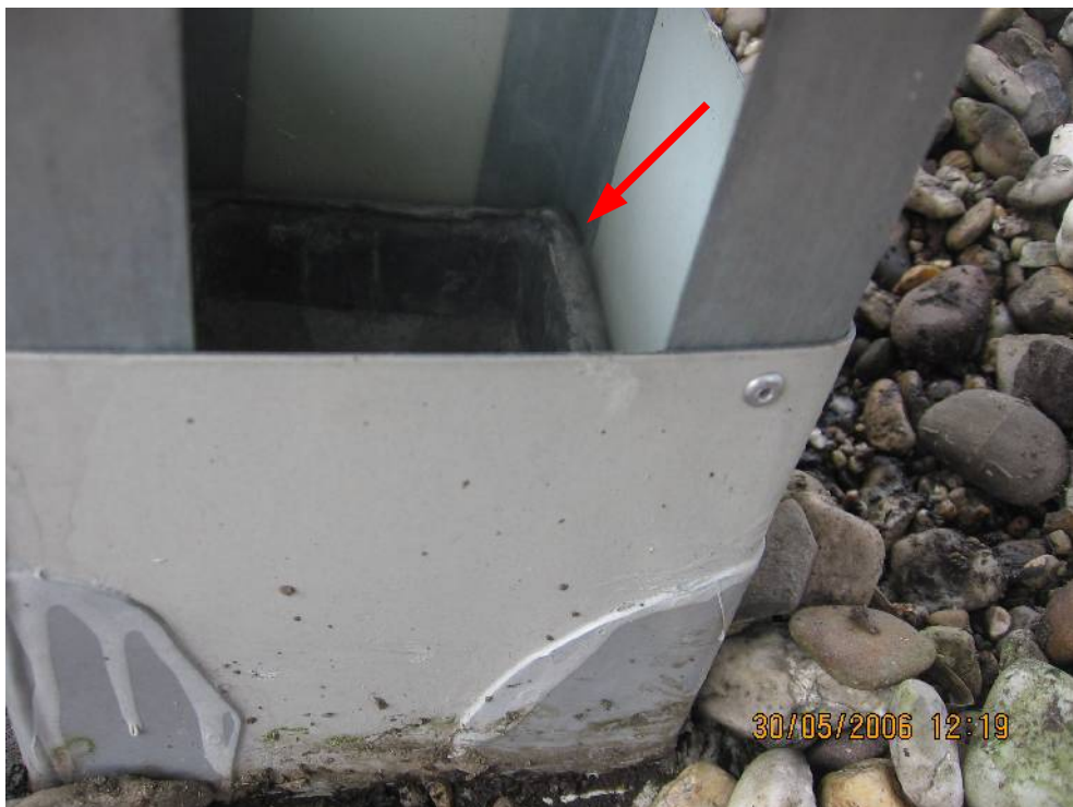
Abbildung 27: Hier dringt Regenwasser ein
