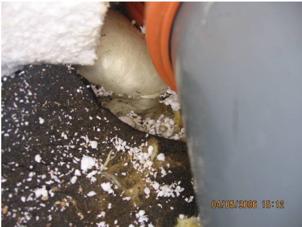
Abbildung 21: Wasser gelangt hier unter die Dampfsperre
