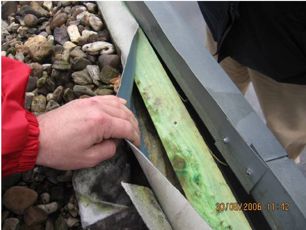
Abbildung 7: Eindringendes Wasser am Dachrand
